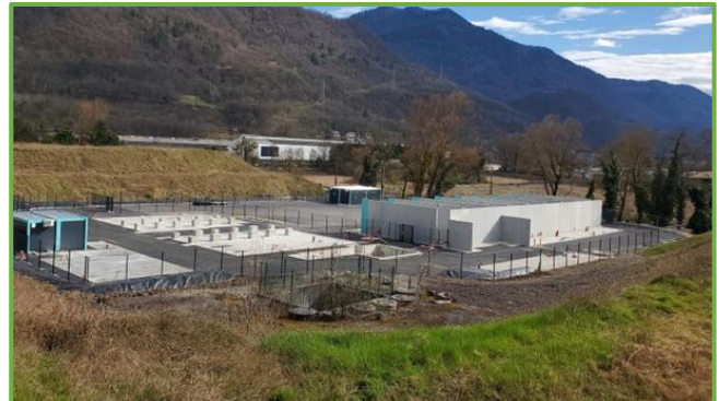
Le Cheylas, 10 MW bulk site (Isère)
