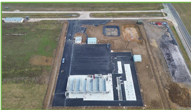
Croixrault, 5 MW bulk site (Hauts-de-France)
