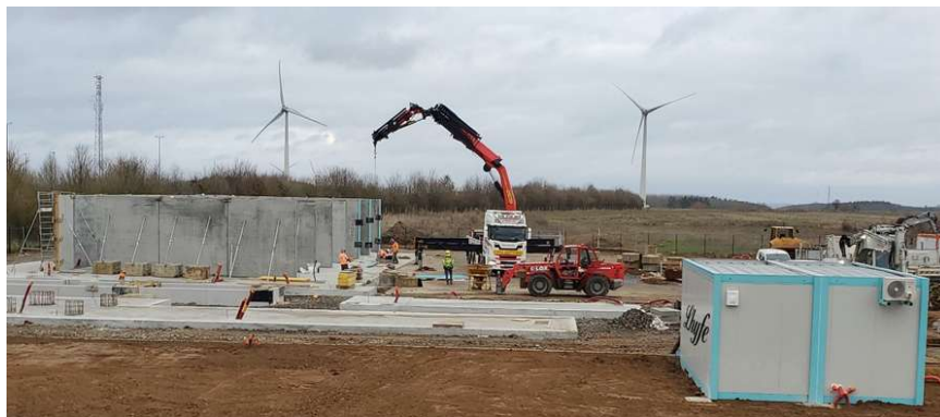
Croixrault, site bulk de 5 MW, Hauts-de-France, France
