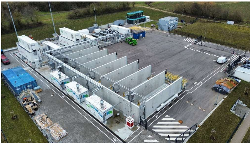
Schwäbisch Gmünd, site bulk de 10 MW, Bade-Wurtemberg, Allemagne
