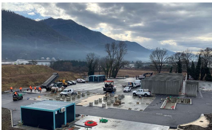
Le Cheylas, site bulk de 10 MW, Isère, France
