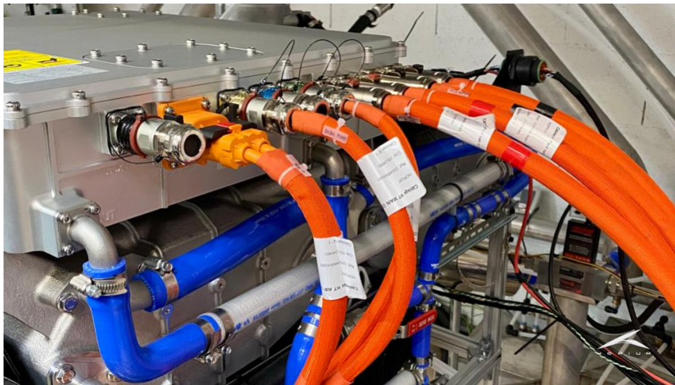
Système complet de la pile 200 kW sur banc d'essai
