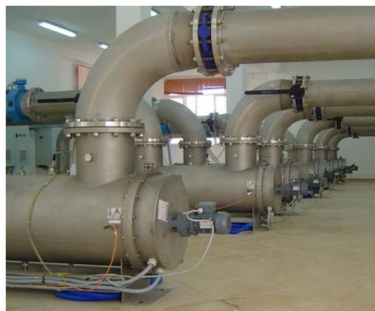
Station d'épuration M'Zar (Maroc)
