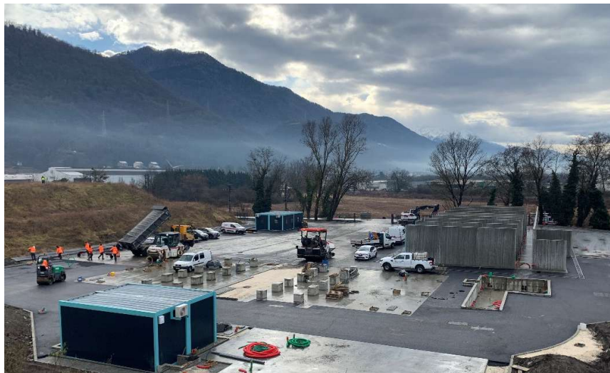
Le Cheylas 10 MW bulk site, Isère, France
