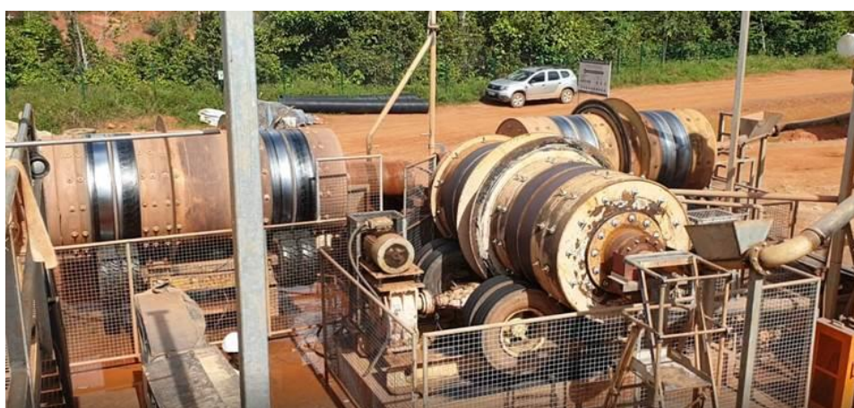
Les 3 broyeurs à boulets sont à présent opérationnels sur le site de Dieu Merci
