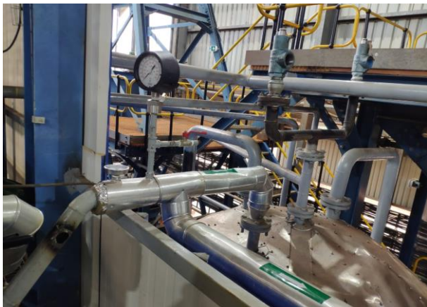
Usine de lixiviation
