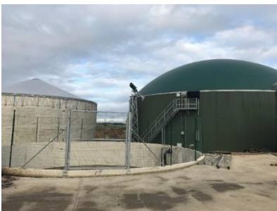
Digesteur et post fosses à digestat
