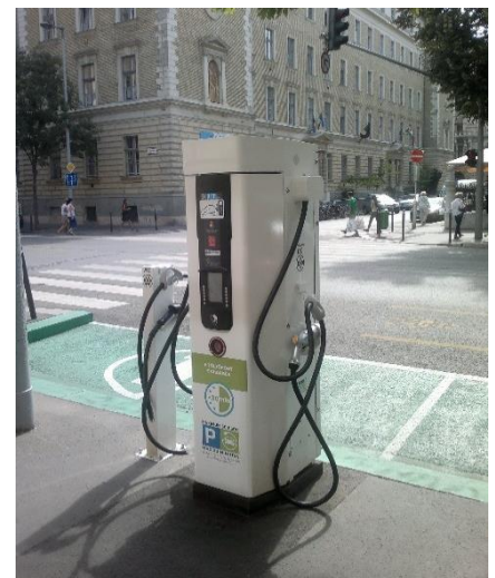
Un chargeur DBT tri-standard installé à Budapest
